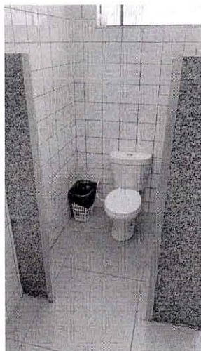
(banheiro sem porta)
